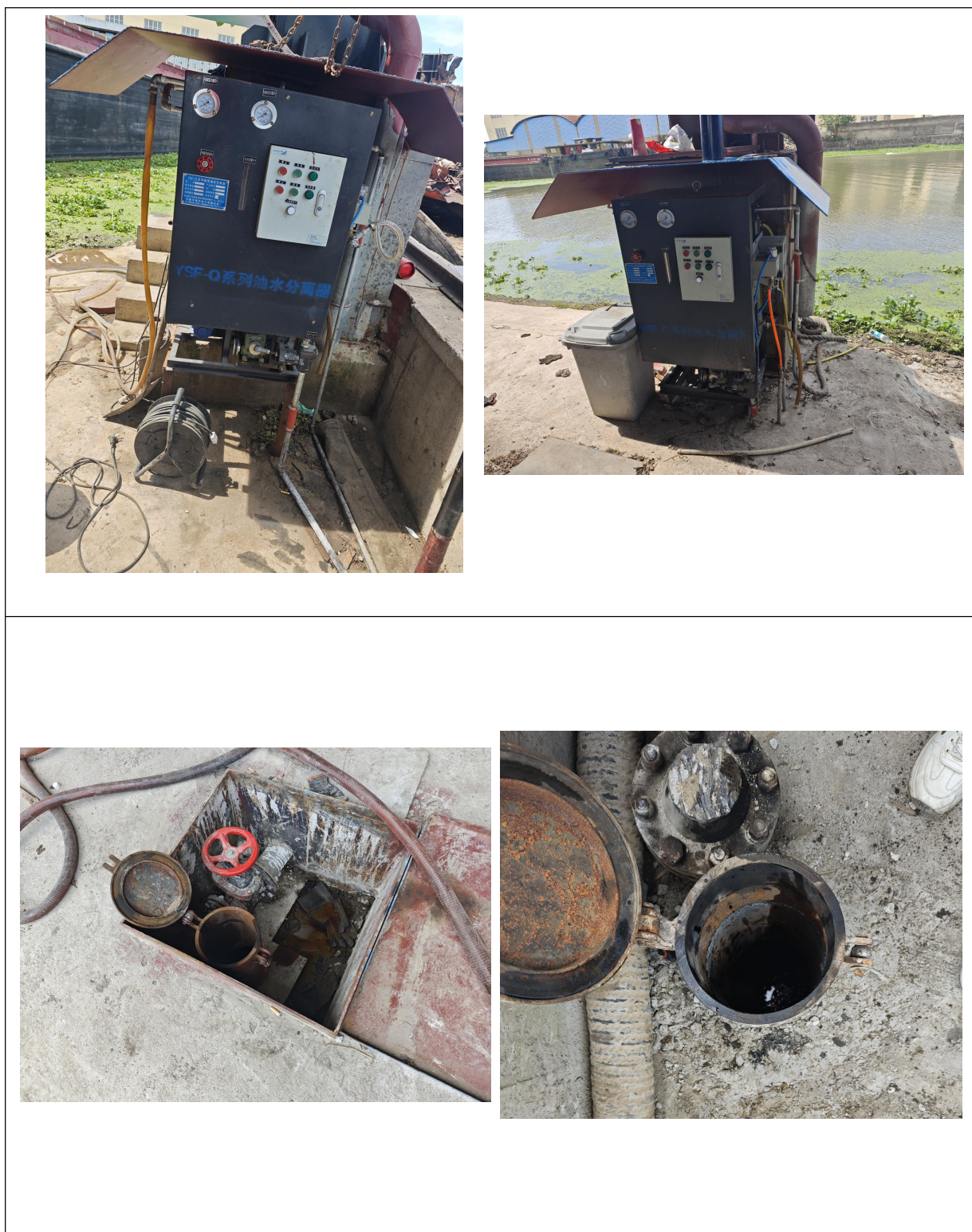
图 4-2 现场实际废水环保设施图
