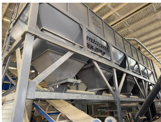
储仓内水泥+管道密闭传输至搅拌机
