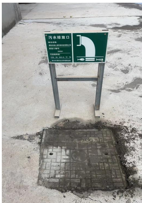
污水排放口（DW001）
