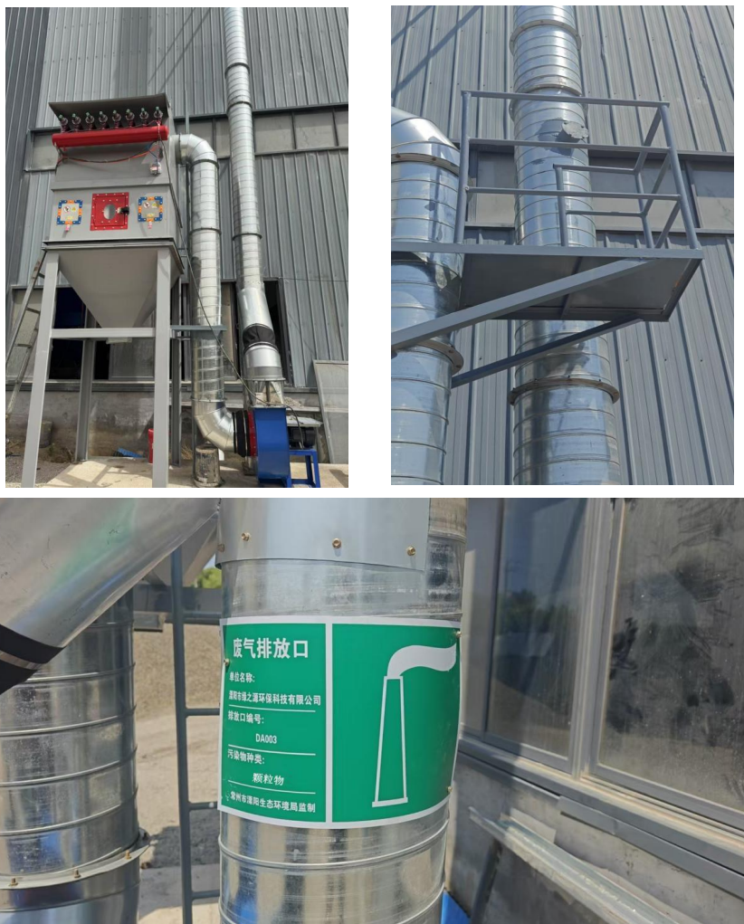
水泥仓储、投料废气排放口及标识牌（DA003）
