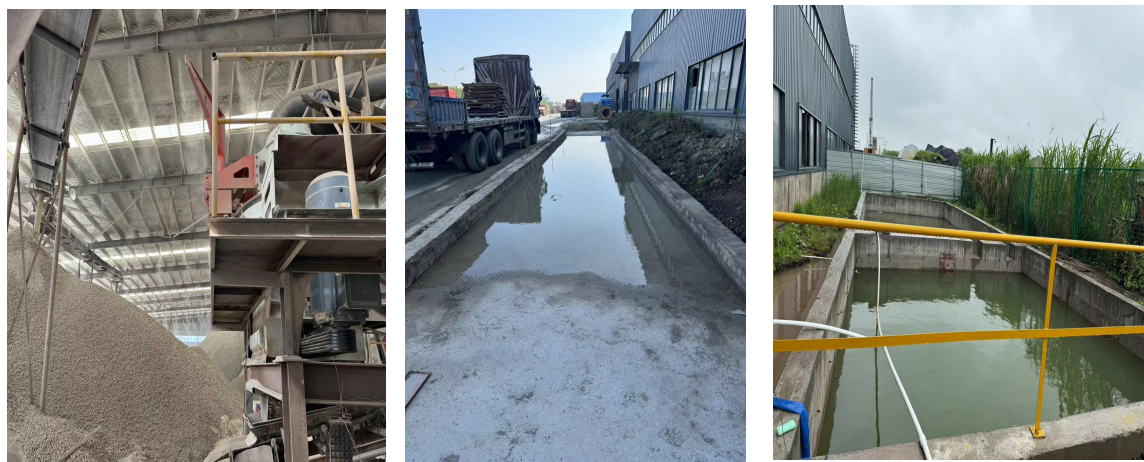
降尘喷淋设施、车辆冲洗池、清洗池
