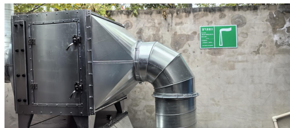
DA003 排气筒标识牌
