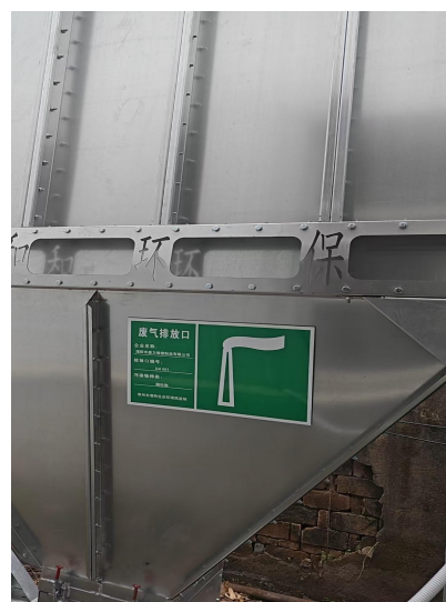
DA001 排气筒标识牌
