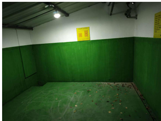
防爆监控及防爆灯
