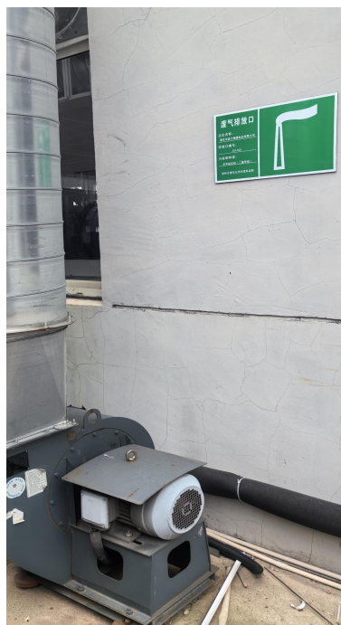
DA002 排气筒标识牌
