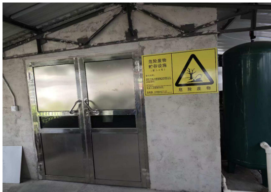
危险废物贮存设施标识牌、可视窗口
